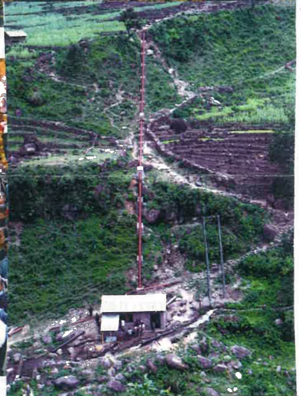
ブジュン村小型水力発電所パワーハウス
